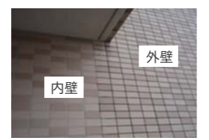
雨による汚れの違い
