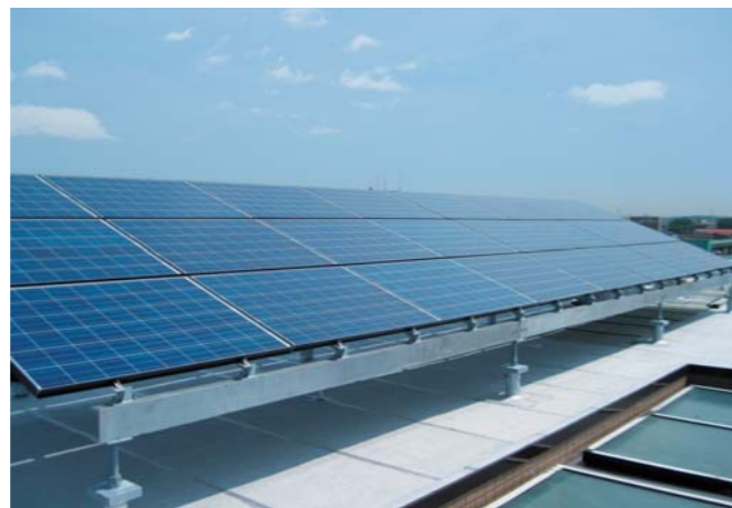
●所在地:東京都足立区 ●物件概要:分譲マンションRC地上5階44戸 ●方式:余剰買取 ●完成:平成24年8月 ●出力:9.84kw
